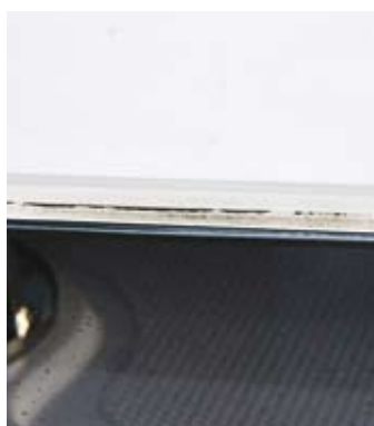
HANSE: Vinduet var i ferd med å løsne fra dekket. Båten er fremdeles tett, men her blir det før eller senere lekkasje. Bra det lett kan fikses.
