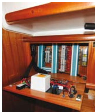
DELPHIA: Det polske verftet bruker fortinnede kabler. Disse tåler salt og fukt mye bedre og vil vare mye lengre. Selv ikke kostbare båter har dette.
