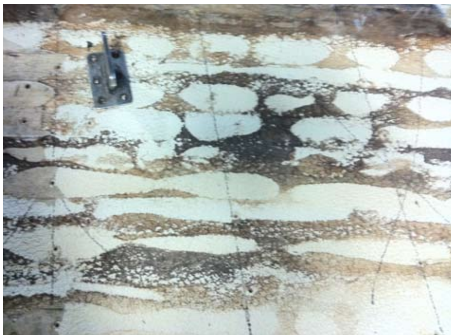
Under teaken hade vattnet runnit. De vita områdena visar var tätningssmassan suttit fast i plasten.
