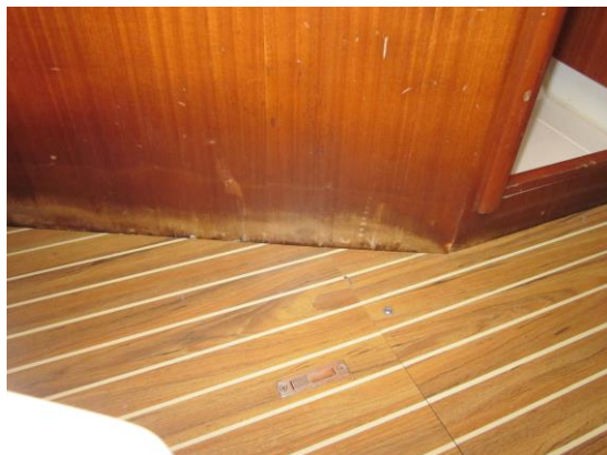
Gamla fuktskador i inredningen.
